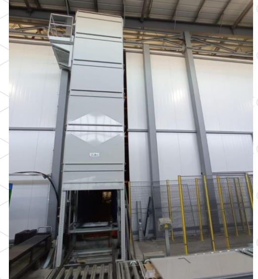
Вертикальные подъемники (лифты)
